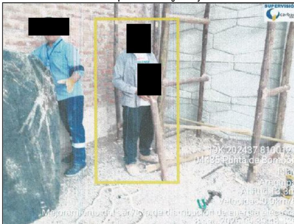
Imagen n.º 04 Falta de Implementos de Seguridad y Salud
