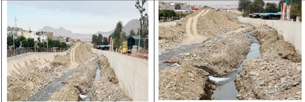
Imágenes n.º 27 y 28: Fotografías de material de excavación acumulado en el cauce del río, ocupando más del 50% del cajón hidráulico, aguas abajo del Puente la Villa.
