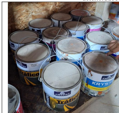
Materiales sin control visible de almacén, el almacenero del proyecto indica que son materiales vencidos.
