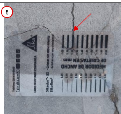
La comisión de control identificó una fisura de 1,2 mm de ancho en el paño ubicado en la intersección de la tercera columna (*) y primera fila (**) del patio de honor
