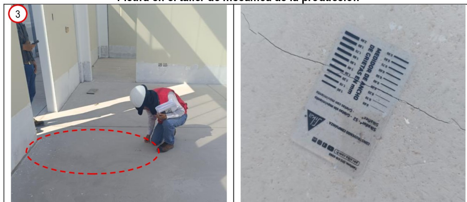
Imagen n.º 22 Fisura en el taller de mecánica de la producción
