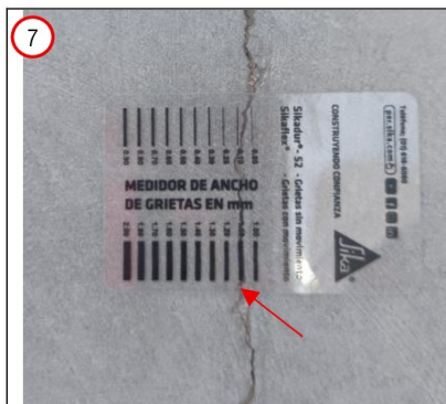
La comisión de control identificó una fisura de 1,1 mm de ancho en el paño ubicado en la intersección de la segunda columna (*) y primera fila (**) del patio de honor
