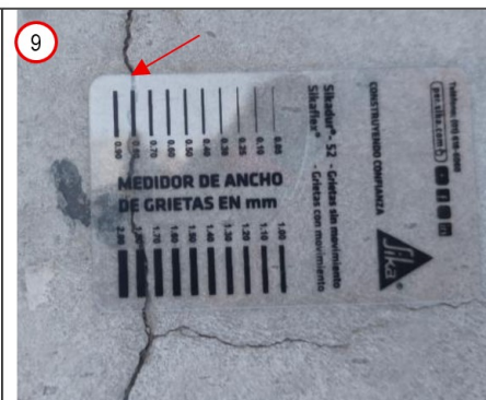
La comisión de control identificó una fisura de 0,8 mm de ancho en el paño ubicado en la intersección de la cuarta columna (*) y primera fila (**) del patio de honor.
