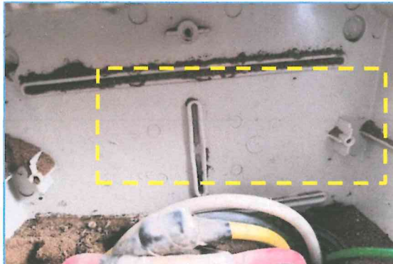
Descripción: Ausencia de elementos complementarios
