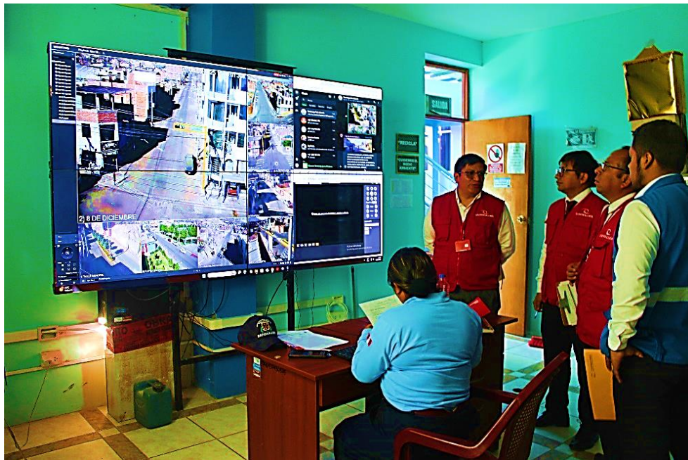
Imagen n.º 30 Sala de monitoreo de cámaras de videovigilancia
