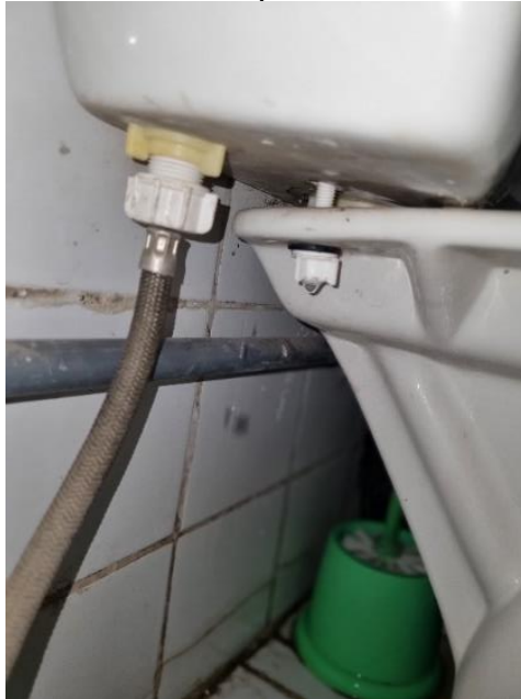
Imagen n.º 33 Gotera proveniente del tanque de inodoro de SSHH de profesores
