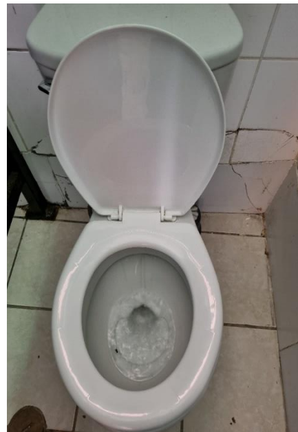
Imagen n.º 32 Sistema de contención de agua en el tanque de inodoro deteriorado en el baño de varones de docentes
