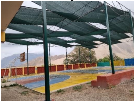
Imagen n.º 60 Losa deportiva de la IE 43087, no se encuentra señalizada como zona segura en caso de sismos
