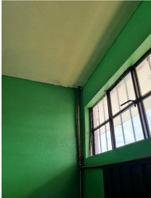
Imagen n.º 29 Filtración de agua proveniente del techo del baño de alumnos
