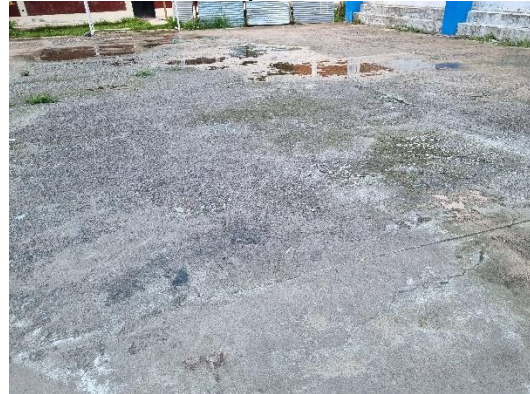
Imagen n.º 19 Desprendimiento de material granular en la losa deportiva
