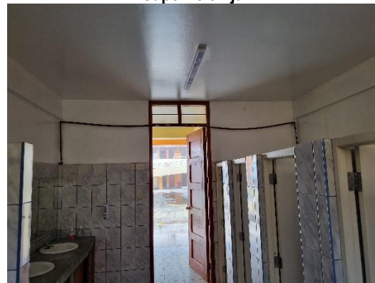
Imagen n.º 36 Tubería para el paso de agua caliente en el baño de alumnas no se encuentra descansando en una superficie fija
