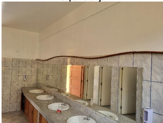
Imagen n.º 35 Tubería para el paso de agua caliente en el baño de alumnos no se encuentra descansando en una superficie fija
