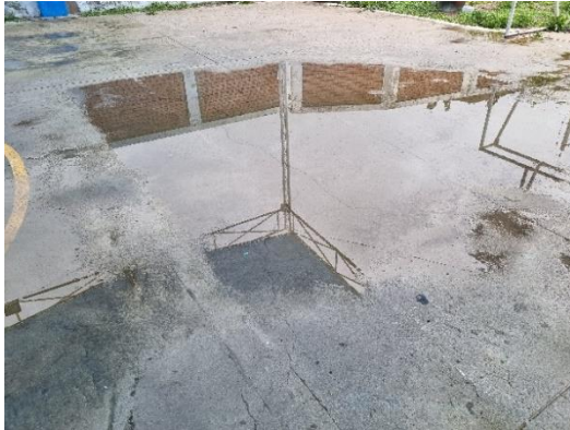
Imagen n.º 18 Presencia de rajadura en la losa deportiva
