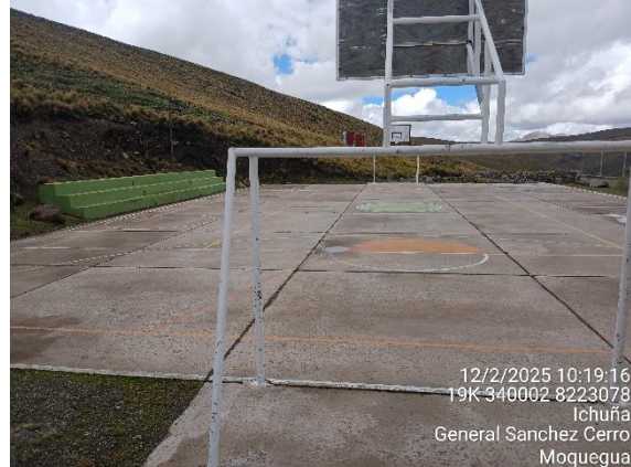
Imagen n.º 59 Patio n.º 2 sin ninguna señalización
