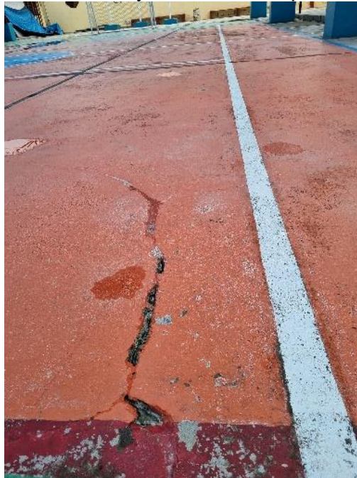
Imagen n.º 20 Presencia de rajaduras en la losa deportiva
