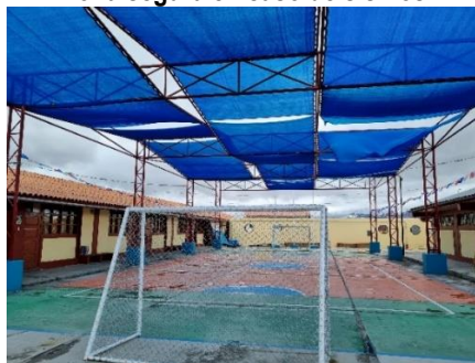
Imagen n.º 62 Losa deportiva no se encuentra señalizada como zona segura en caso de sismos
