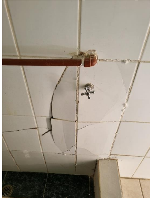
Imagen n.º 30 Rotura de tubería en el baño de varones de docentes debido al congelamiento del agua
