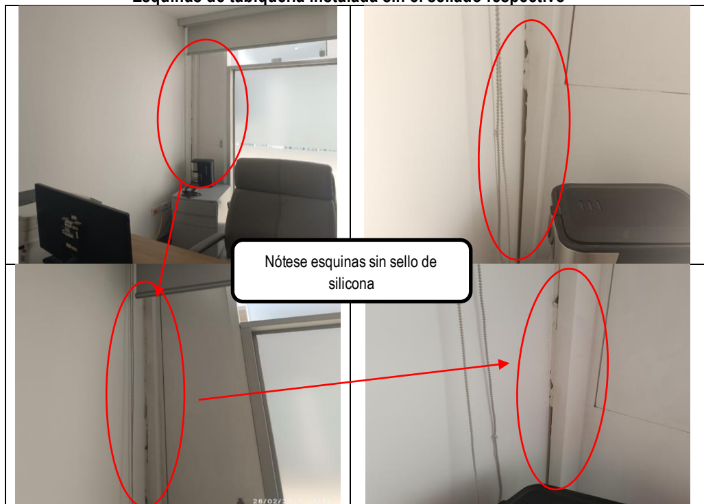
Imágenes n.ºs 8, 9, 10 y 11 Esquinas de tabiquería instalada sin el sellado respectivo
