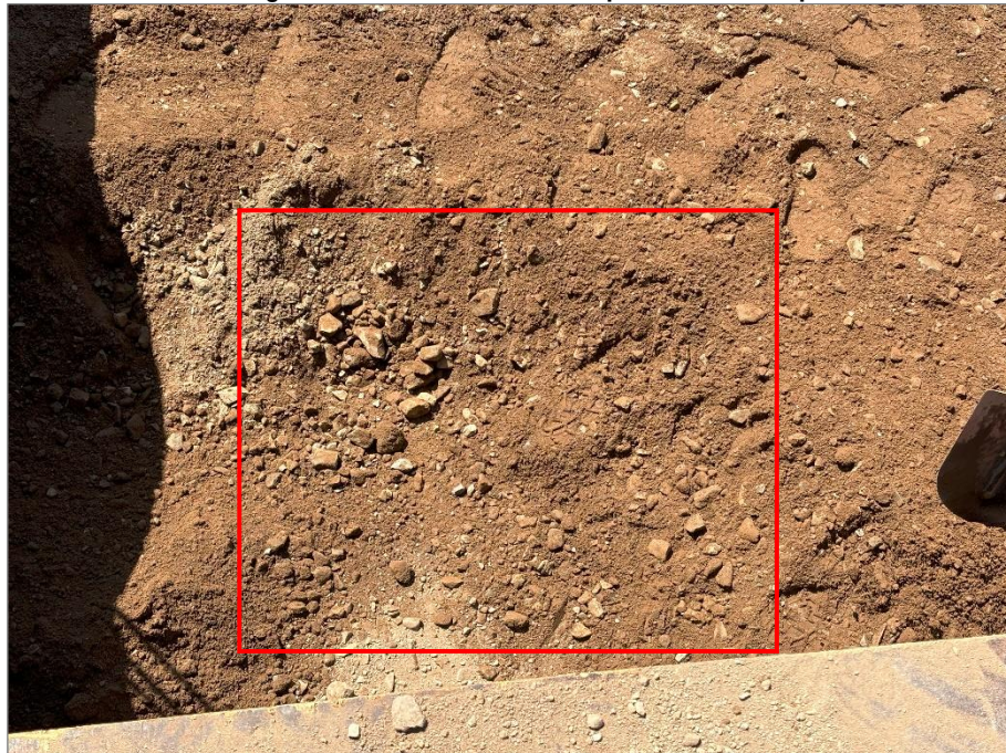
Imagen n.º 8 Presencia de grava en material de relleno previo a su compactación
