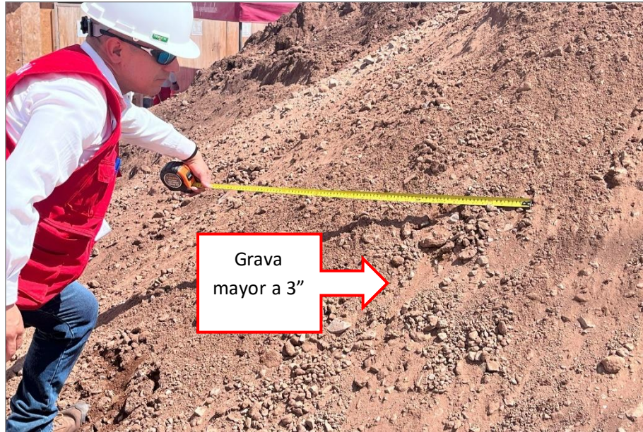
Imagen n.º 7 Material de relleno expuesto a intemperismo
