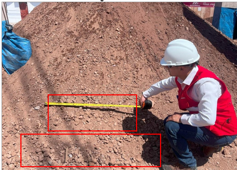
Imagen n.º 6 Presencia de grava en material de relleno
