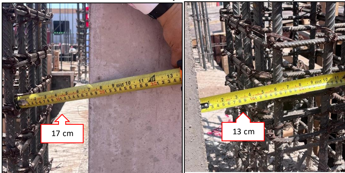
Imagen n.ºs 3 y 4 Detalle de la distancia de la junta sísmica entre los bloques B y C
