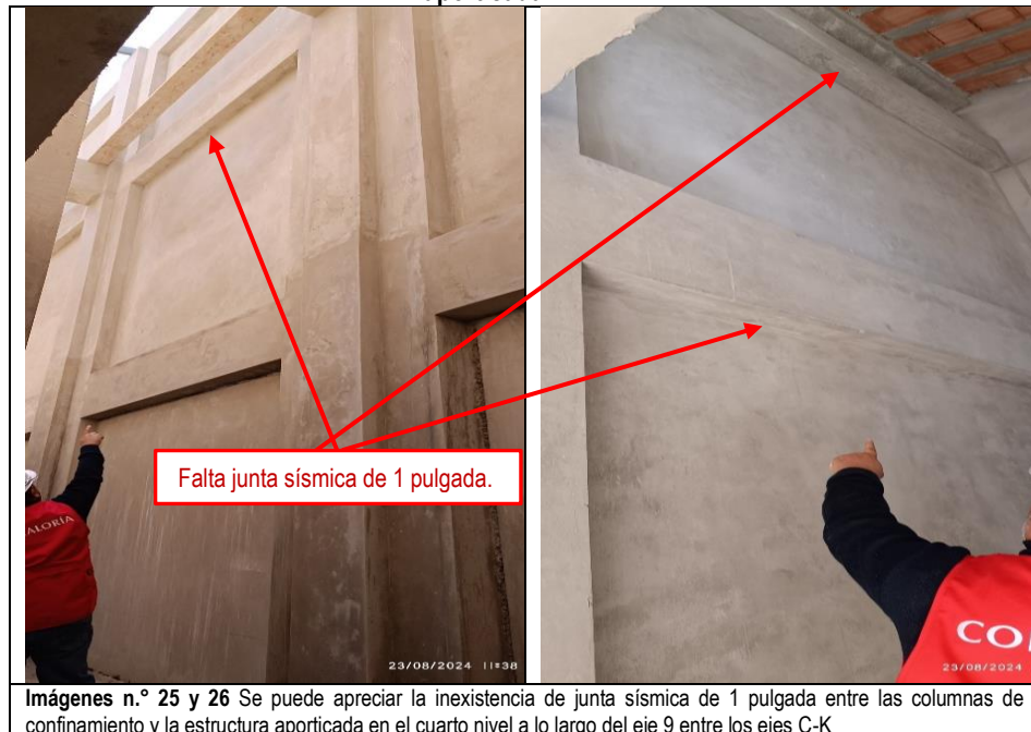
Imagen n.º 25 y 26 Ausencia de junta sísmica de 1" entre las columnas de confinamiento y la estructura aporticada
