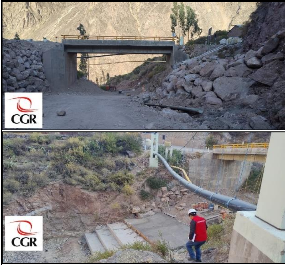
Imagen n.º 6 y 7 Zona de trabajo sin señalización preventiva, ejecución partida “03.09 Dentellón y aliviadero de concreto ciclópeo para barraje”
