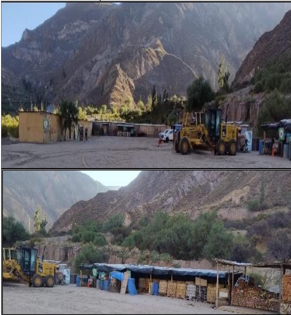
Imágenes n.º 4 y n.º 5 Campamento de obra sin la señalización
