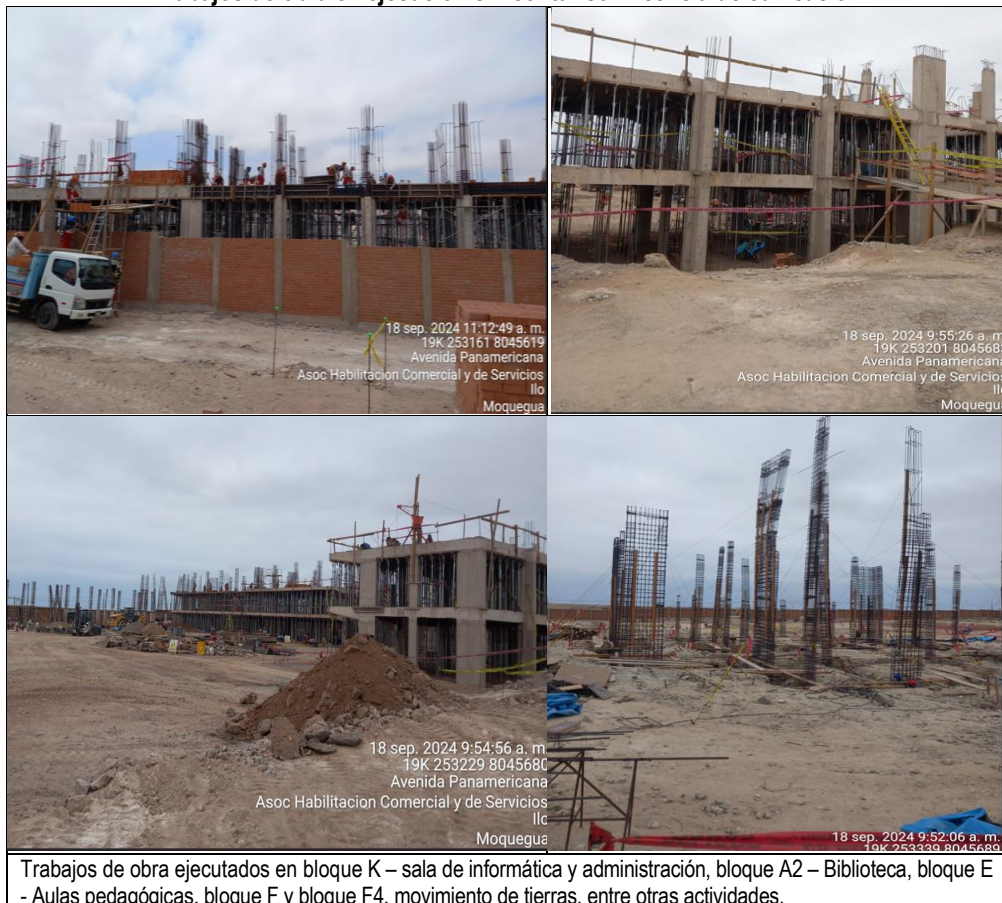
Imagen n.º 8, n.º 9, n.º 10 y n.º 11 Trabajos de obra en ejecución sin contar con licencia de edificación
