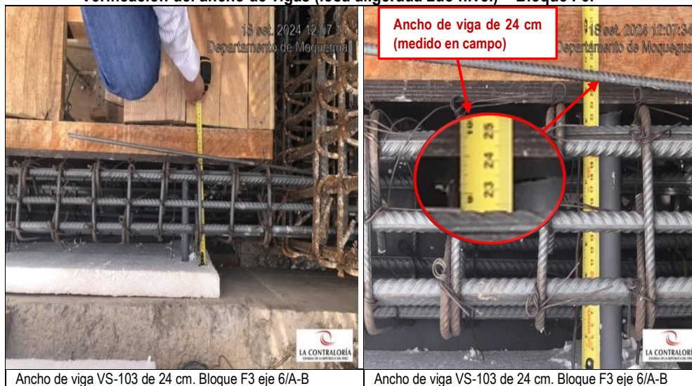
Ancho de viga VS-103 de 24 cm. Bloque F3 eje 6/A-B Ancho de viga VS-103 de 24 cm. Bloque F3 eje 6/A-B Fuente: Acta de visita de inspección n.º 02-2024-GRM/OCI-SCC-2476202 de 18 de setiembre de 2024.
