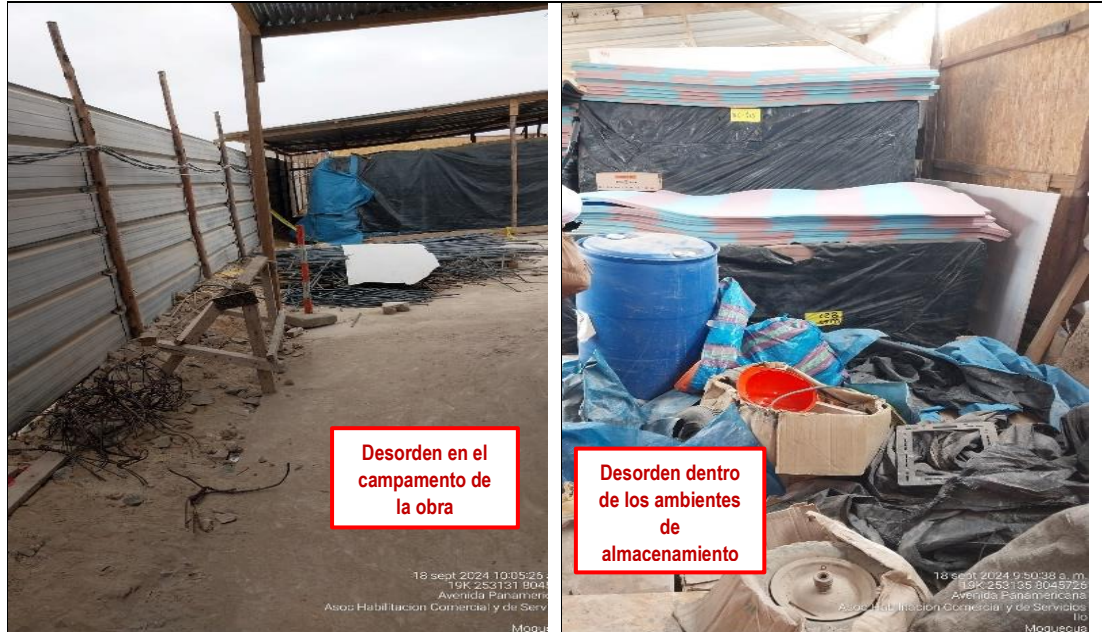
Imágenes n.º 109 y n.º 110 Falta de orden en la obra
