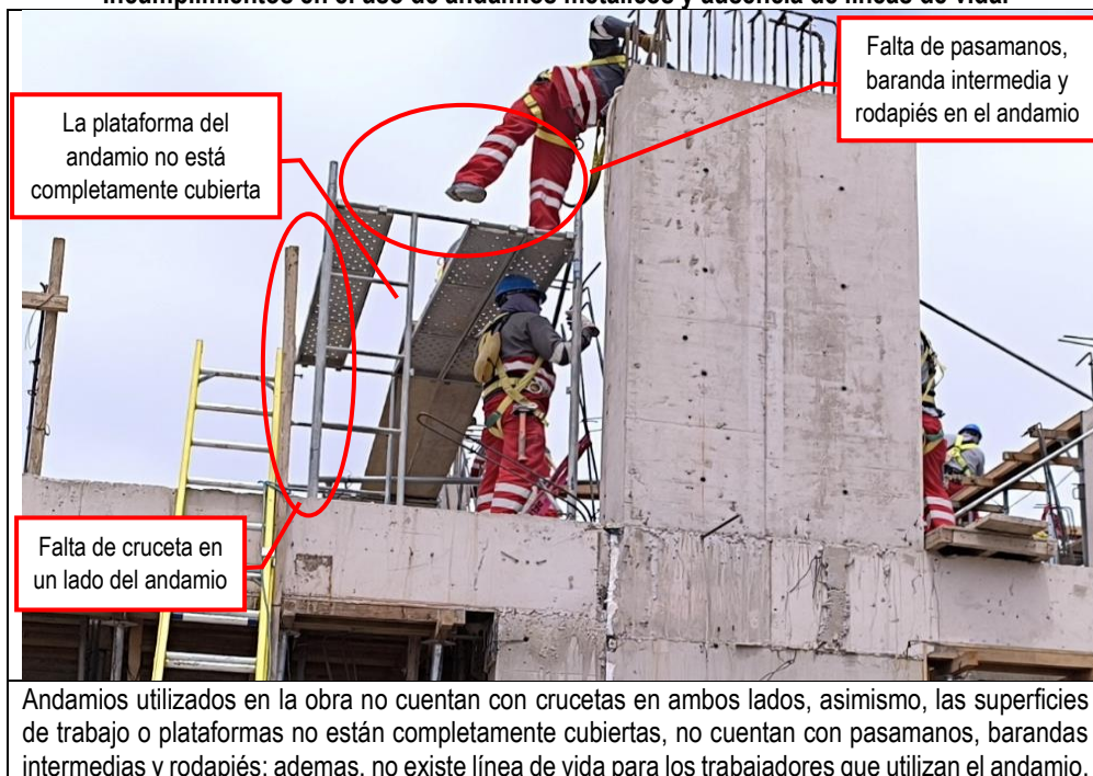
Imágenes n.º 87 Incumplimientos en el uso de andamios metálicos y ausencia de líneas de vida.
