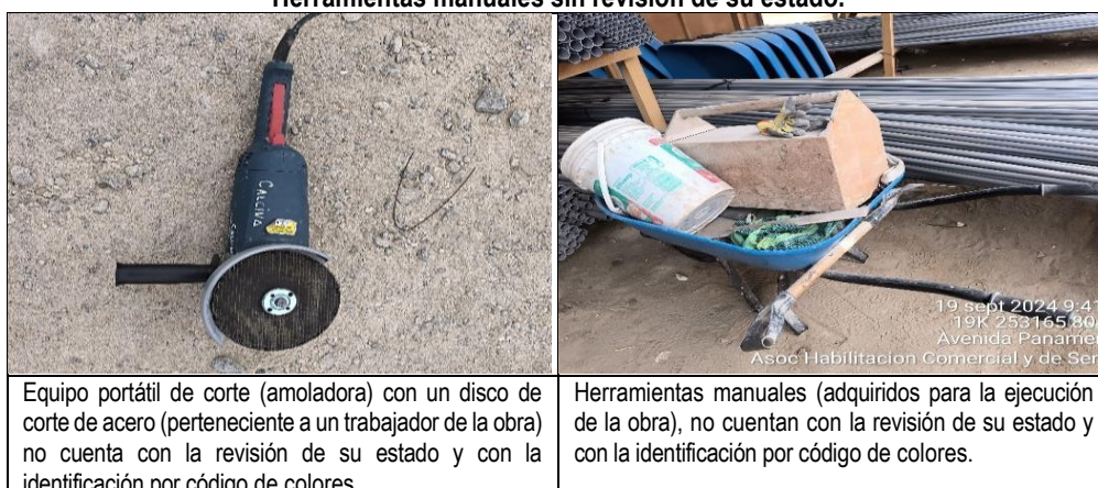
Imágenes n.º 67 y n.º 68 Herramientas manuales sin revisión de su estado.
