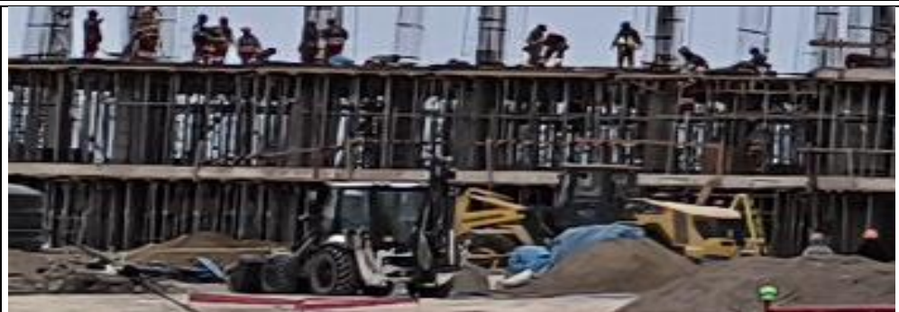
No existe un área de parqueo de maquinaria pesada, por lo cual, se advierte que estos se dejan estacionados en las áreas de trabajo de la obra al término de jornada, originando el riesgo de accidentes de trabajo.
