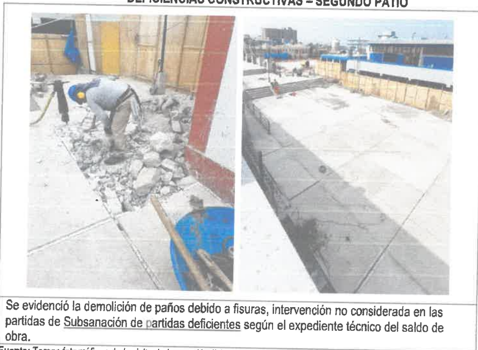
IMAGEN N° 4 DEFICIENCIAS CONSTRUCTIVAS – SEGUNDO PATIO
