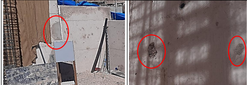
Vacios u oquedades en el concreto y resanes para cubrir estas deficiencias.
