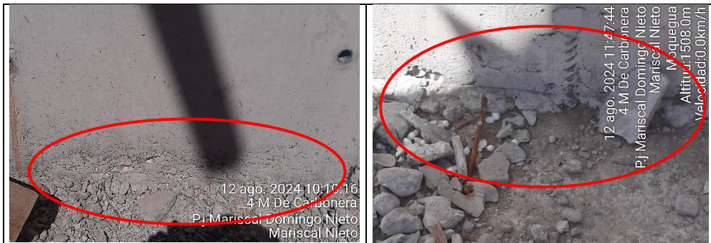
Vacios u oquedades en el concreto ubicados en la union de las pantallas y zapatas de los muros de contención.
