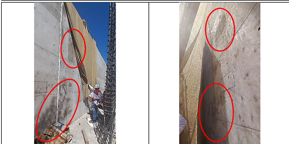
Resanes para cubrir los vacíos u oquedades en el concreto en las pantallas de los muros de contención, asimismo, las telas de yute y las superficies del concreto se encontraron completamente secas.
