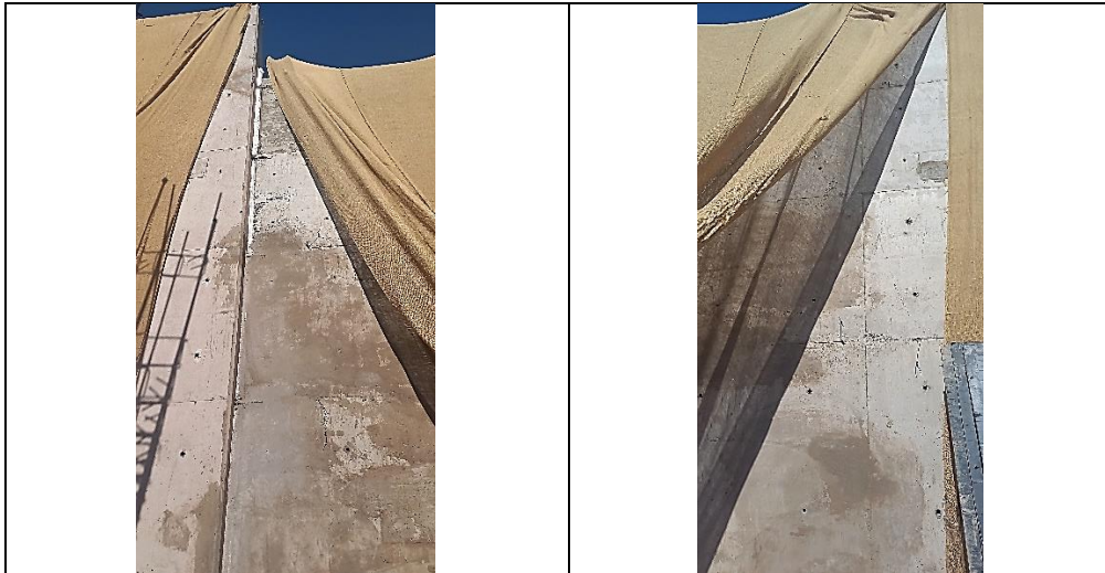
Resanes para cubrir los vacíos u oquedades en el concreto en las pantallas de los muros de contención, asimismo, las telas de yute y las superficies del concreto se encontraron completamente secas.
