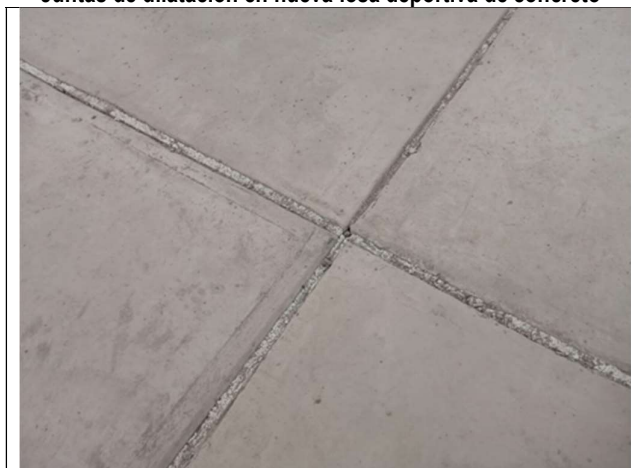
Juntas de dilatación, una transversal y otra longitudinal ejecutada en nueva losa deportiva de concreto.
