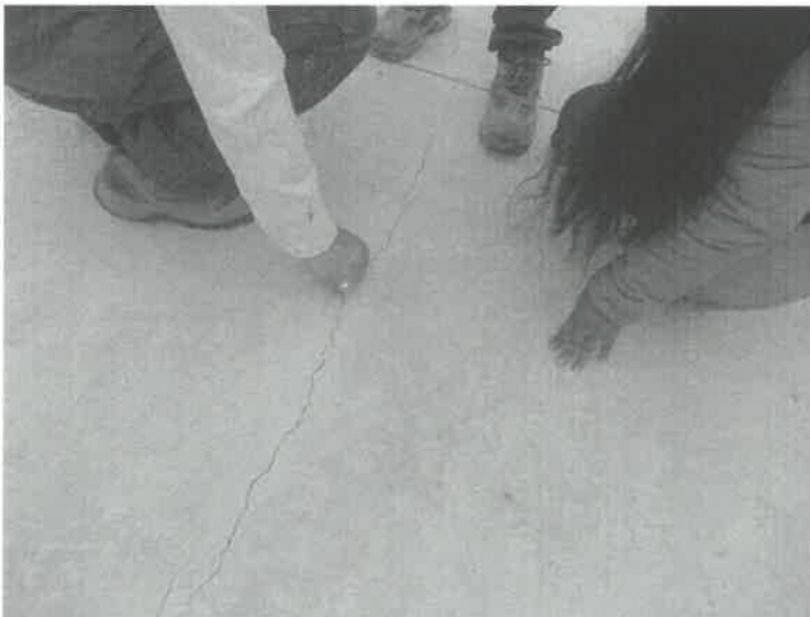
Fisura en losa de concreto
