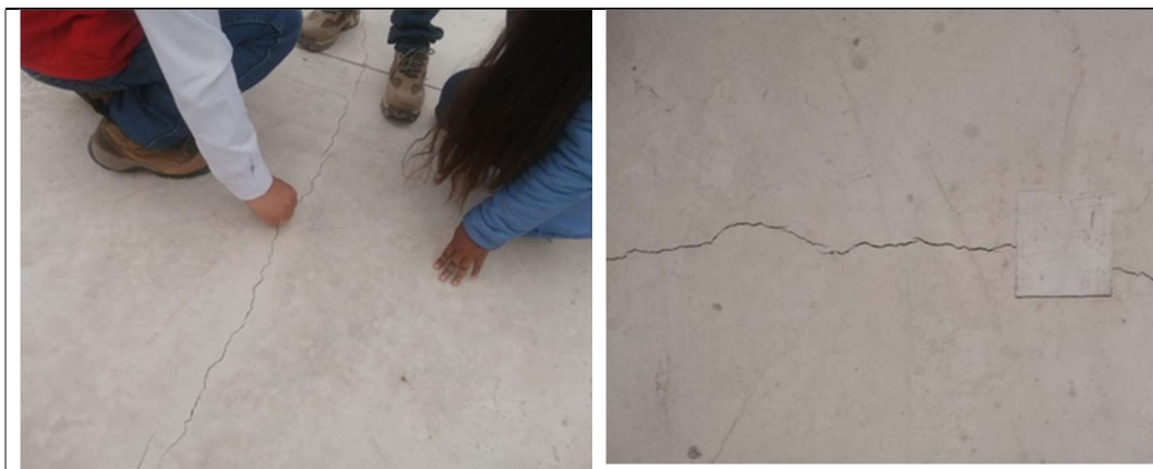
Imágenes n.ºs 6 y 7 Fisuras en nueva losa deportiva de concreto
