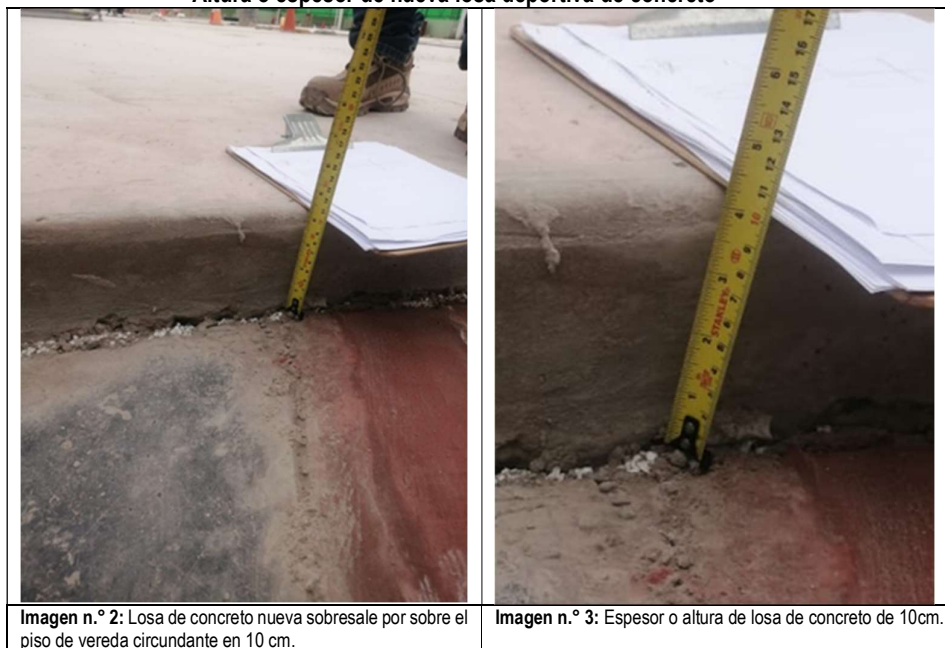
Imagen n.º 2: Losa de concreto nueva sobresale por sobre el piso de vereda circundante en 10 cm. Imagen n.º 3: Espesor o altura de losa de concreto de 10cm.
