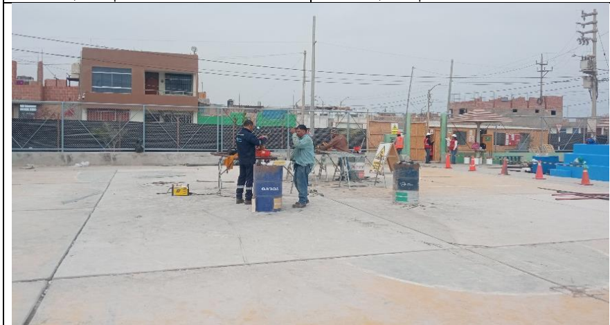
Imagen n.º 11: Trabajos en proceso de ejecución del cerco metálico, correspondiente de la orden n.º 3691.
