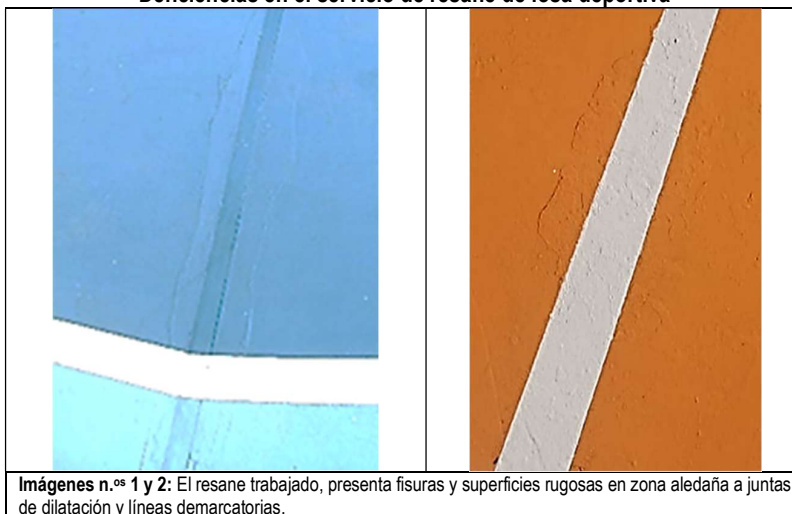
Imágenes n.ºs 1, 2, 3 y 4 Deficiencias en el servicio de resane de losa deportiva
