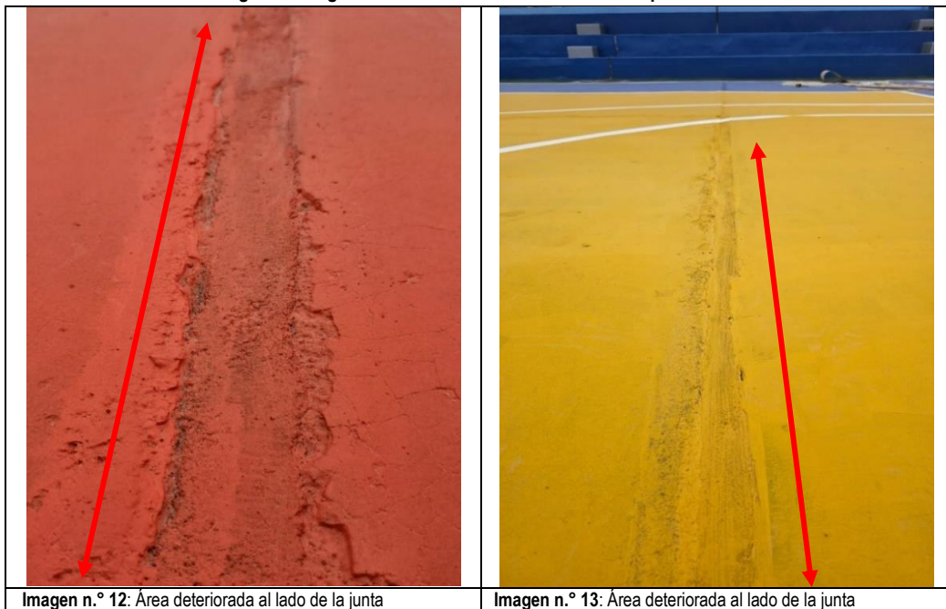
Imagen n.° 12: Área deteriorada al lado de la junta
