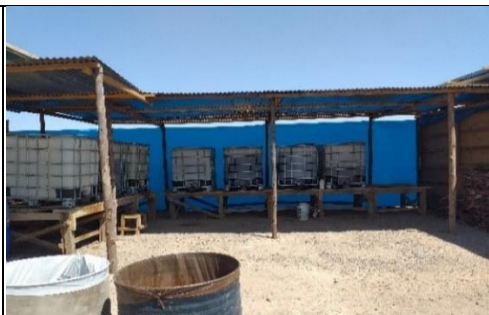
Almacén de materiales peligrosos (combustibles) con piso de tierra y sin bandejas de HDPE.
