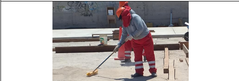
Trabajador realizando trabajos que generan polvo sin la protección respiratoria correspondiente.
