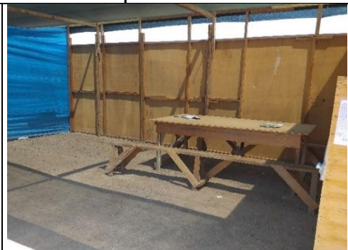
El comedor no cuenta con falso piso de cemento, tiene techo de malla raschel, además solo cuenta con una mesa de 1.22 m x 2.44 m y dos bancas de madera sin ningún tipo de protección superficial y con riesgo de contaminación (insalubre), siendo insuficiente para los 18 obreros.
