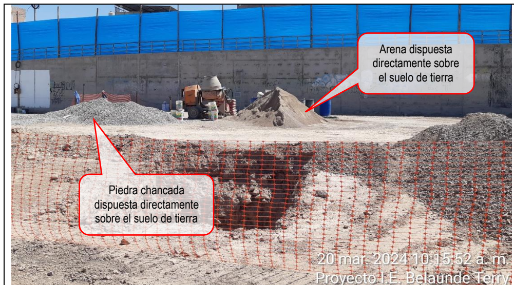
Imagen n.º 116 Agregados almacenados directamente sobre el suelo, sin mecanismos que eviten su segregación y contaminación con otros materiales o su mezcla con agregados diferentes.
