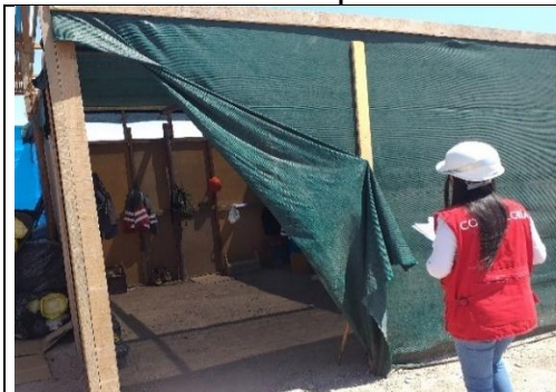
El vestuario no se encuentra en un ambiente cerrado, no cuenta con falso piso de cemento, tiene techo de malla raschel, además no cuenta con casilleros para cada trabajador y no existe vestuario exclusivo para damas.
