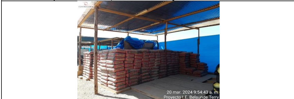
Cemento portland puzolánico tipo IP x 42.5 kg, marca Frontera no cuenta con tarjeta de control visible.
