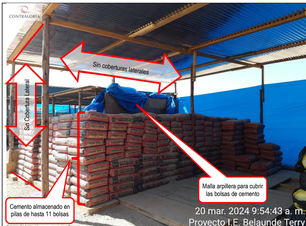
Imagen n.º 114 Deficiencias en el almacenamiento de cemento.
