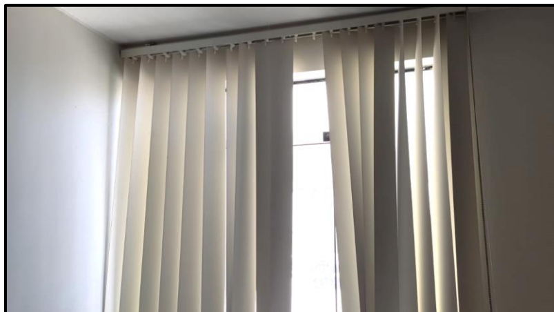
Fuente: Tomas fotográficas realizadas durante Visita de Control Elaborado por: Comisión de Control
