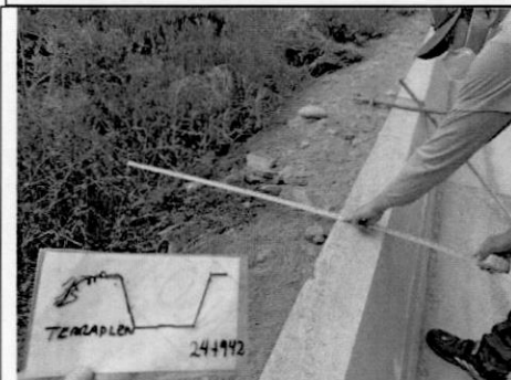
Imagen n.º 7: Se aprecia que en el canal Km 24+942 no existe terraplén conformado al lado izquierdo.
