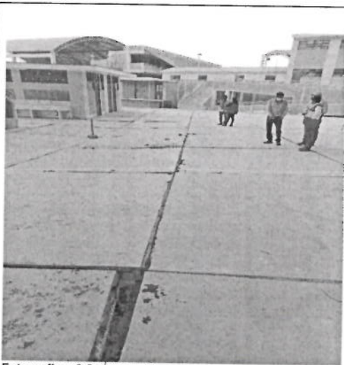
Fotografía n.º 8: Área en la que convergen asentamientos de hasta 48, 30.5 y 35.5 centímetros, respectivamente, en la gradería de la indicada Losa, Servicios Higiénicos y Patios de Acceso.
