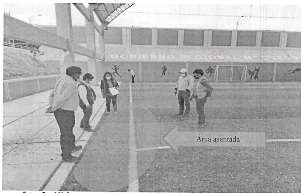
Fotografía n.º 22: Se aprecia el asentamiento de un sector del de la Cancha de Fútbol de Grass Artificial
