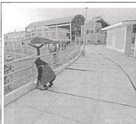
Fotografía n.º 18: Verificación del desplazamiento lateral e inicio de proceso de volteo del segundo, tercer, cuarto, quinto y sexto paño del muro de contención de patio de acceso
