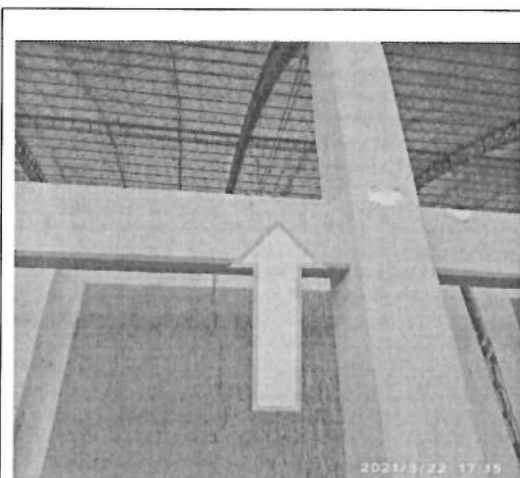
Fotografía n.º 20: Se aprecia la existencia de fisuras en la segunda viga, pórtico de concreto armado que soporta la cobertura liviana
