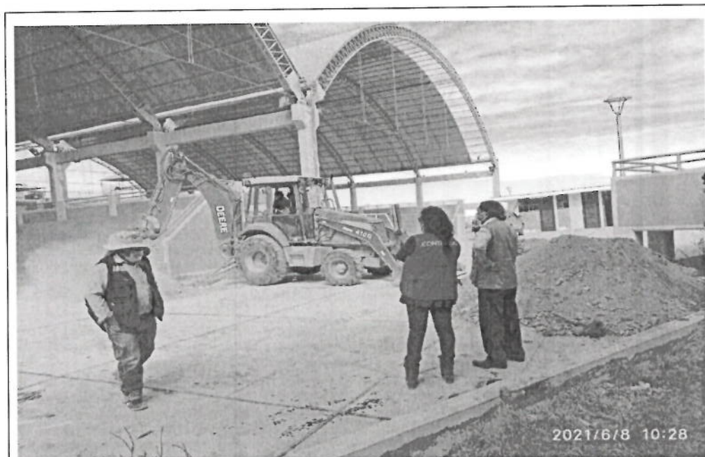
Fotografía 2: Captada en la visita de inspección física a obra el 8 de junio de 2021, en la que se corrobora que, por los asentamientos producidos, se siguen soltando los templadores de la estructura metálica, tanto de la losa deportiva de usos múltiples y de la cancha de fútbol.
